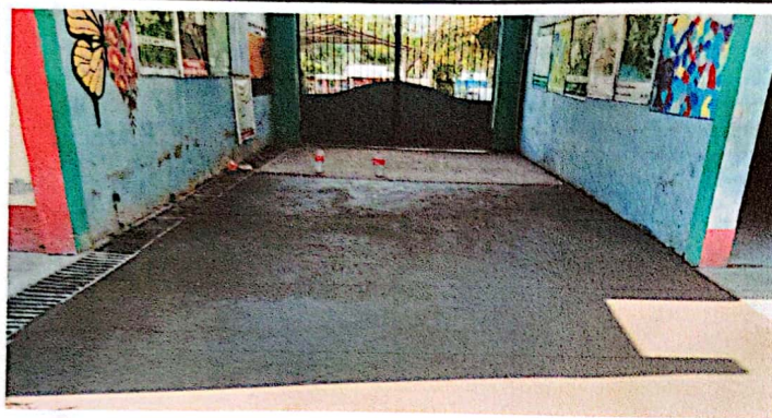
FOTO 1: Sustrucción de piso de torta de concreto
